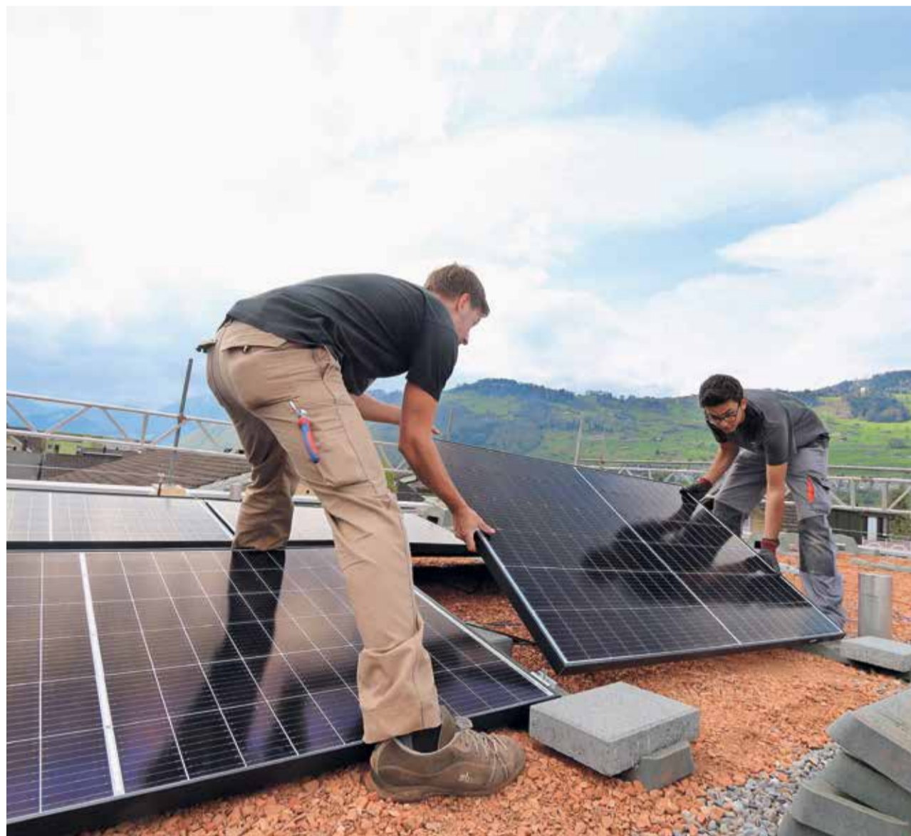
Für Neubauten und bei Dachsanierungen sieht das neue kantonale Energiegesetz eine Pflicht zur Nutzung der Sonnenenergie vor. FOTO: ARCHIV UW
